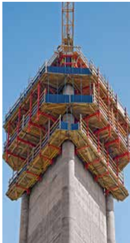
Alternatywą dla pełnego osłonięcia mogą być rury i deski poręczy zapewniające zabezpieczenie boczne.
