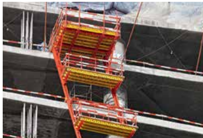
Wysuwnice mogą wspinąć się przy użyciu szyn za pomocą przenośnych siłowników hydraulicznych RCS – pozwala to dodatkowo zminimalizować użycie żurawia.
