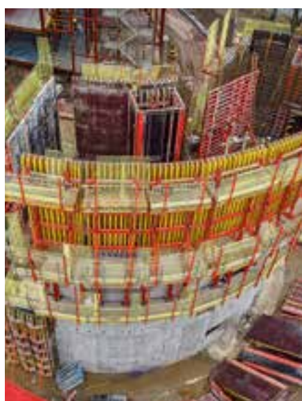
Zastosowanie lekkiego szynowego systemu wspinania z dźwigarowym deskowaniem ściennym VARIO GT 24 na budynku ze ścianami łukowymi.
