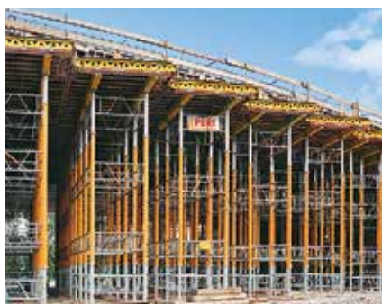
Wieże MULTIPROP jako konstrukcja podporowa dla indywidualnie zaprojektowanych stołów stropowych.
