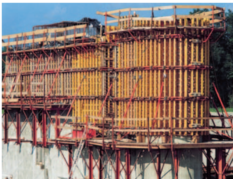
Strona czołowa filara. VARIO w połączeniu z systemem desek łukowych GRV na pomostach roboczych KGF 240.
